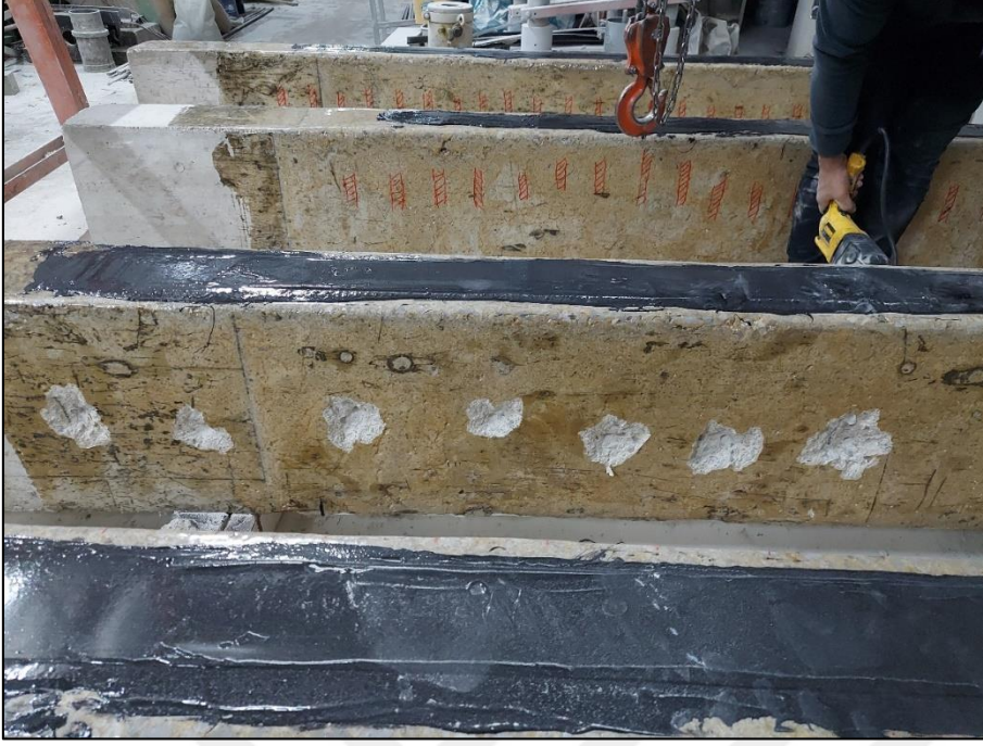
Resim 3.21. Ankrage deliği açma işlemleri sırasında oluşan deformasyonlar
