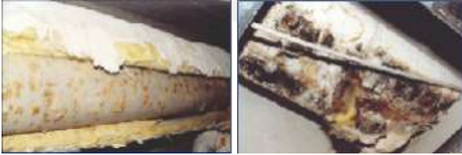
Resim 2.2. Yoğuşma sonucu kanalın ve yalıtımının deformasyonu (MEGEP, 2008)
