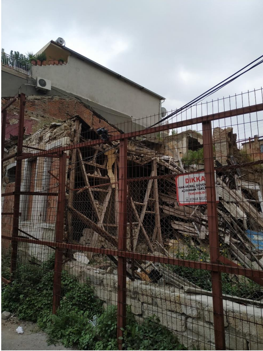
Şekil 6.1. Çalışma alanında bulunan "yıkılmış" bir yapı (Yazarın kişisel arşivinden)
