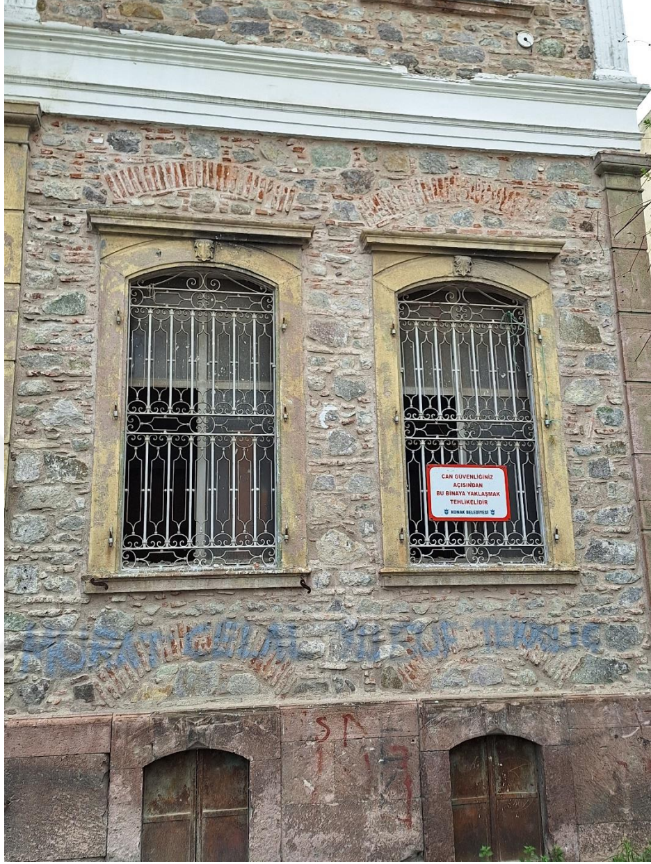
Şekil 6.2. Çalışma alanında bulunan "yıkılmak üzere" olan bir yapı (Yazarın kişisel arşivinden)
