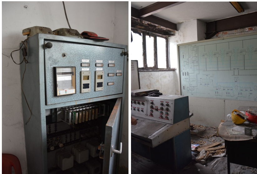
Şekil 5. 33: Filtrasyon tesisi kontrol panelleri. Merve Varol Can, 2023.
