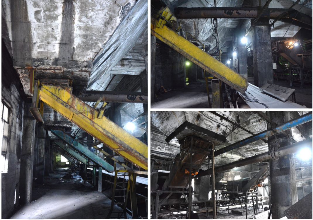
Şekil 5. 30: Betonarme kat içerisinde yer alan temiz kömür siloları. Merve Varol Can, 2023.
