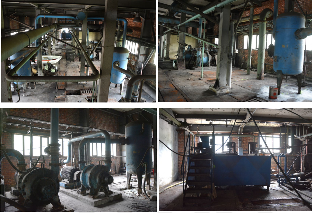
Şekil 5. 34: Kompresör ve vakum kazanları, sulu çökelti tankı. Merve Varol Can, 2023.
