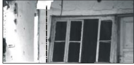
Kapı ve pencerelerde görülen burulmalar
