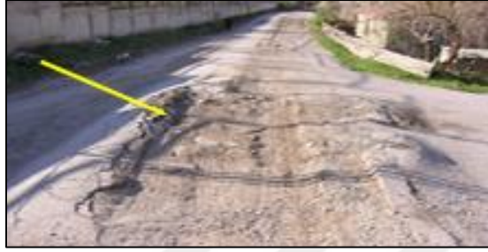
Yolda görülen kabarma kaynaklı bozulmalar
