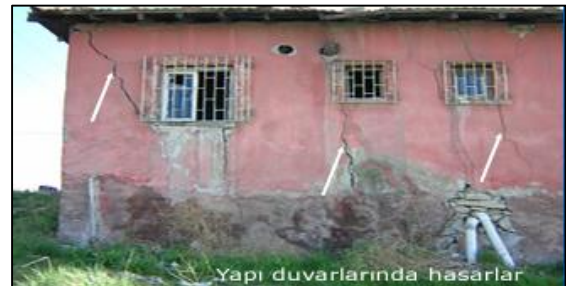
Yapı duvarlarında görülen hasarlar
