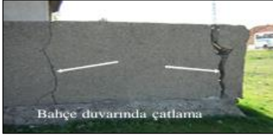
Bahçe duvarlarında görülen hasarlar
