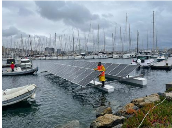
Şekil 2.50. Yüzer GES Uygulama Örneği
