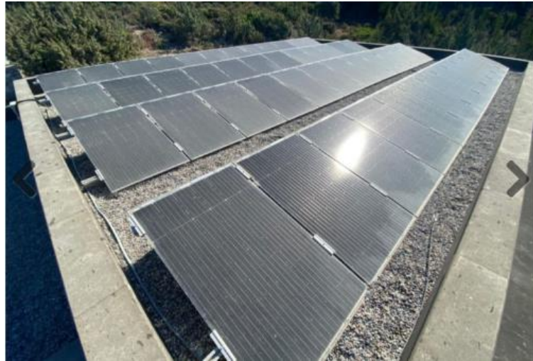
Şekil 2.52. Konut Çatı GES Örneği
