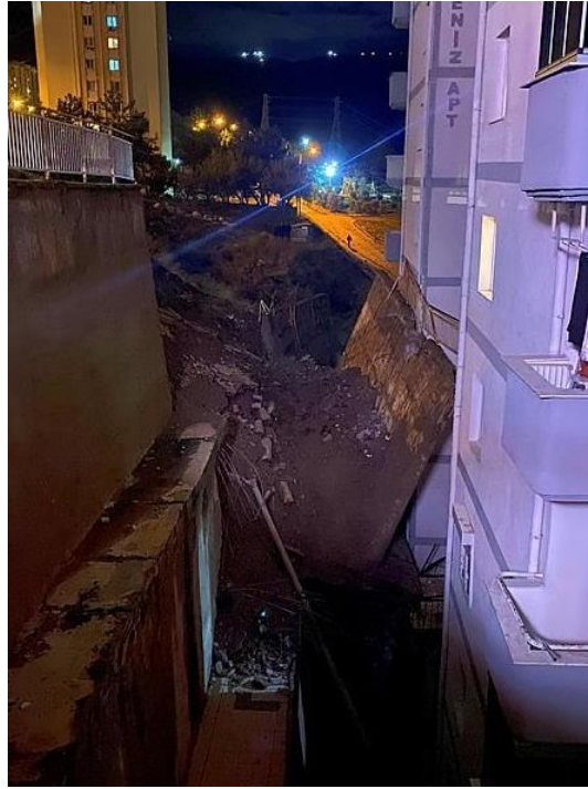
Şekil 2. İstinat duvarı göçme örneği-2 (Kaynak: İzmir,2021)
