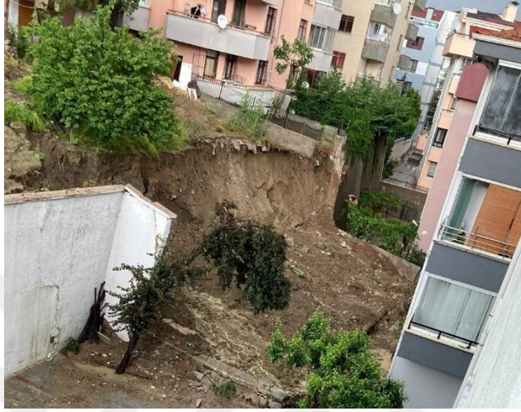
Şekil 1. İstinat duvarı göçme örneği-1 (Kaynak: Ankara, 2022)
