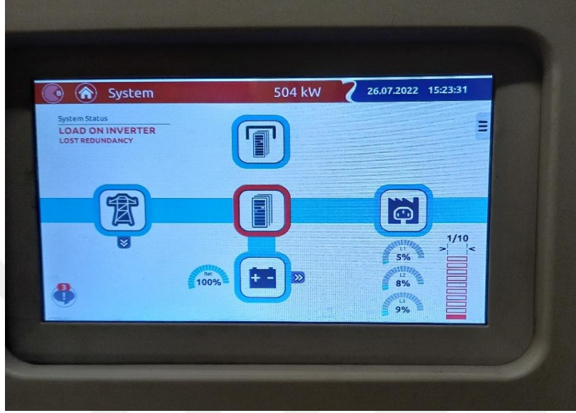
Şekil 3.8 Modüler kesintisiz güç kaynağı (ups) paneli güç gösterimi
