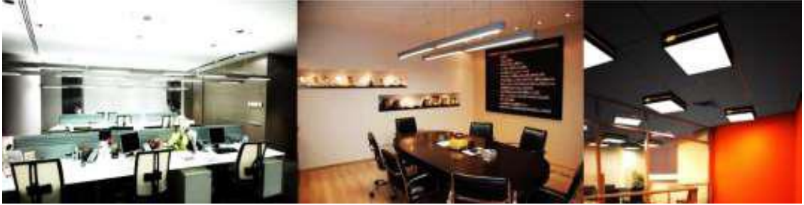
Şekil 2.1 Aydınlatma armatür uygulama örnekleri
