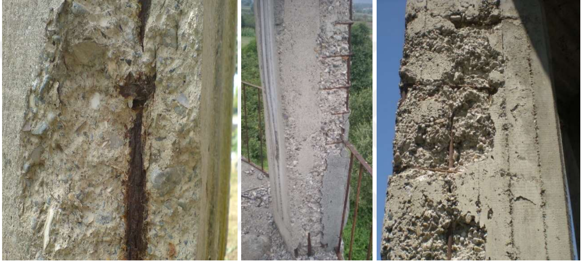
Şekil 1.5. Ayaklı su deposu kolonlarında beton ve donatı malzemesi hataları
