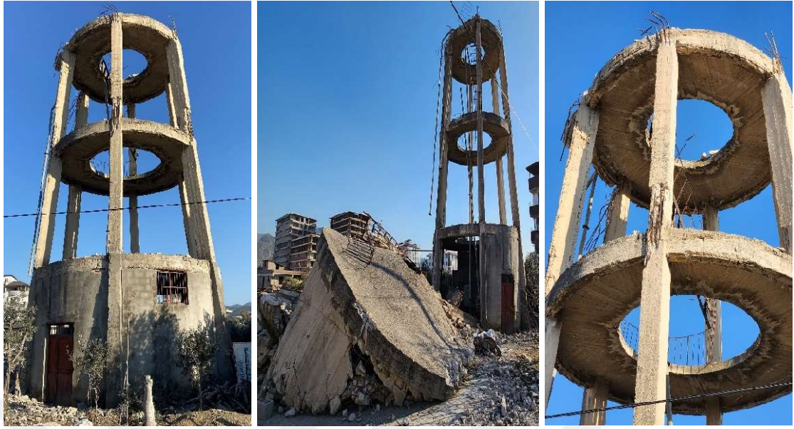
Şekil 2.6. Hatay-Antakya yıkılan ayaklı su deposu
