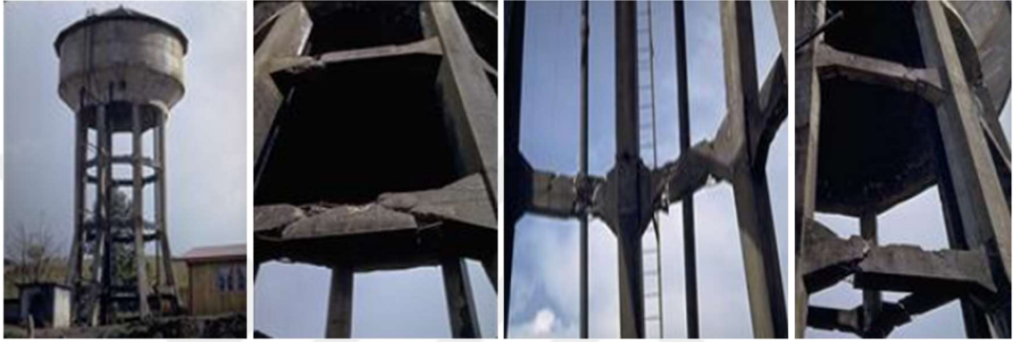
Şekil 2.1. Otel Puerto Varas ayaklı su deposu (PEER, 2024)
