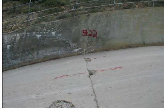
Şekil 1.3 : Kaldırmaya bağlı ilk hasar.
