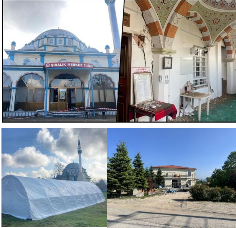
Şekil 6.22. Depremde hasar alan Şıralık Eski Camii ve Günümüz Yeni Camii İnşaatı.
