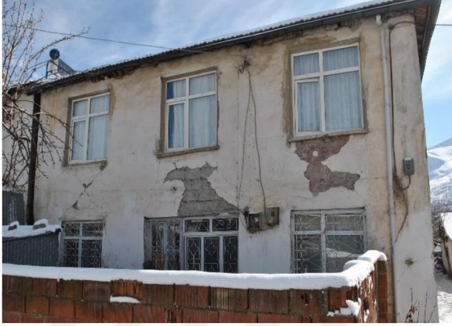
Şekil 3.5. Yığma yapı deprem hasarı (Türkoğlu A. , 2022).
