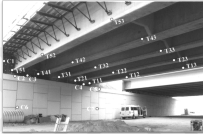
Şekil 4.3 Las Alturas Bridge köprüsü deformasyonu için çalışmalar (Jaauregui vd., 2003).
