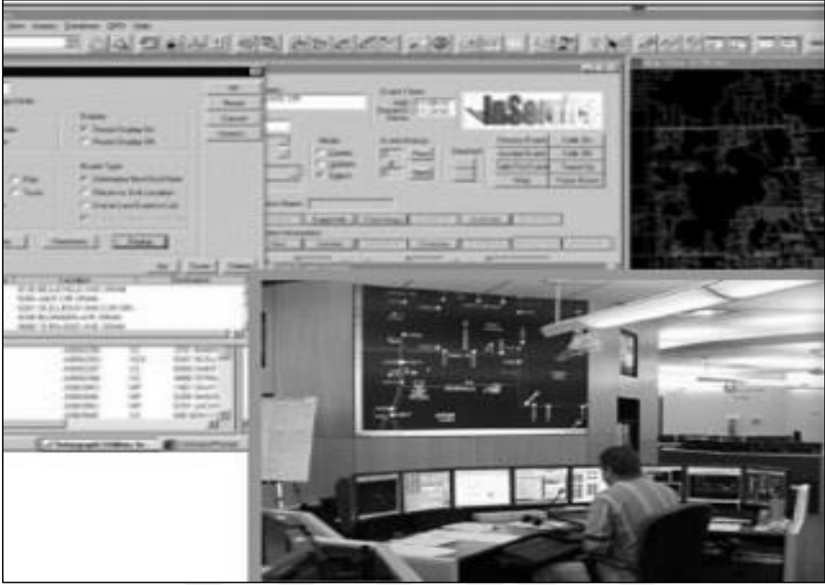
Resim 2.6. Acil çağrı sistemleri [17]
