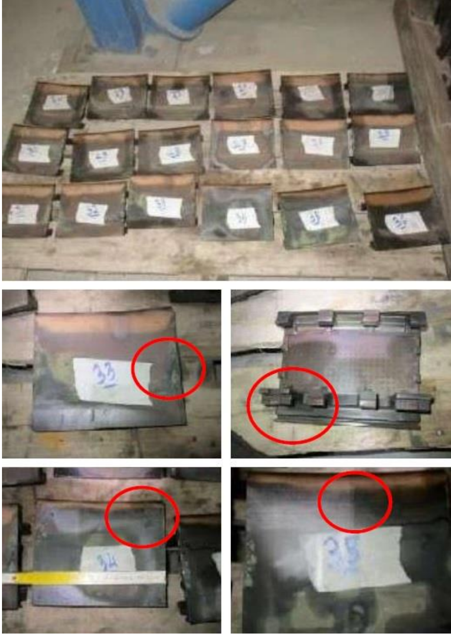
Resim 5.21. Türbin stator ısı tuğlası segmentleri [7]
