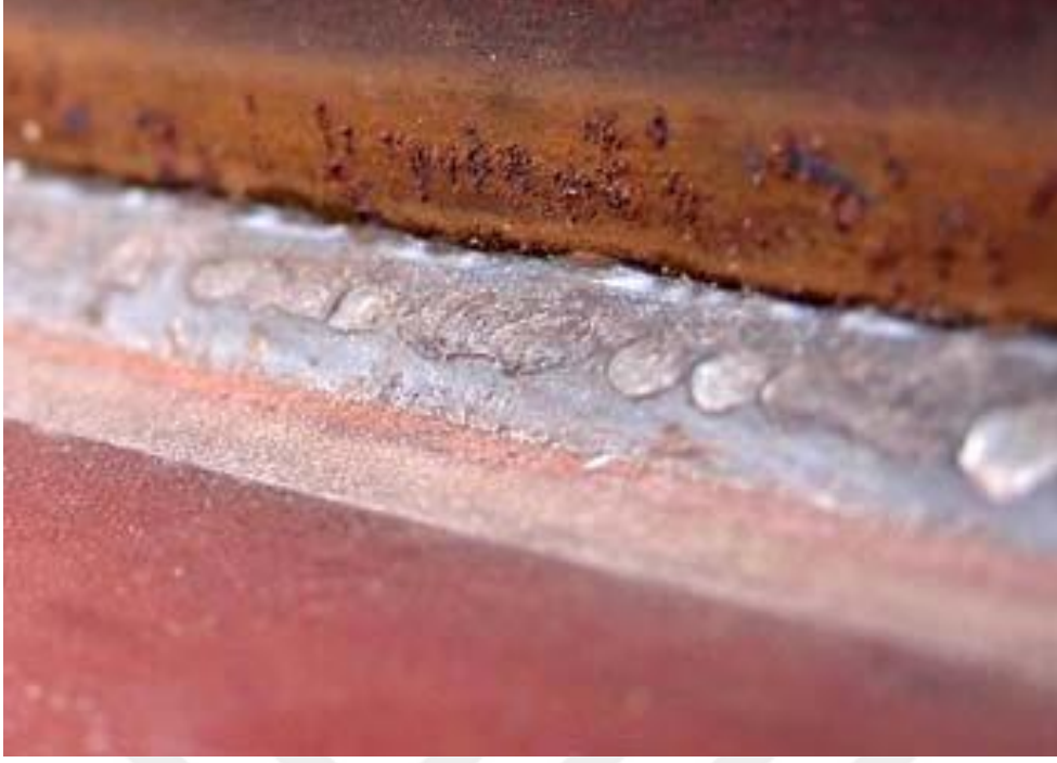
Şekil 3.14 : Kaynak bölgesinde yanma oluđu oluşumu (Statkinov, Korostel, & Fricke, 2007).
