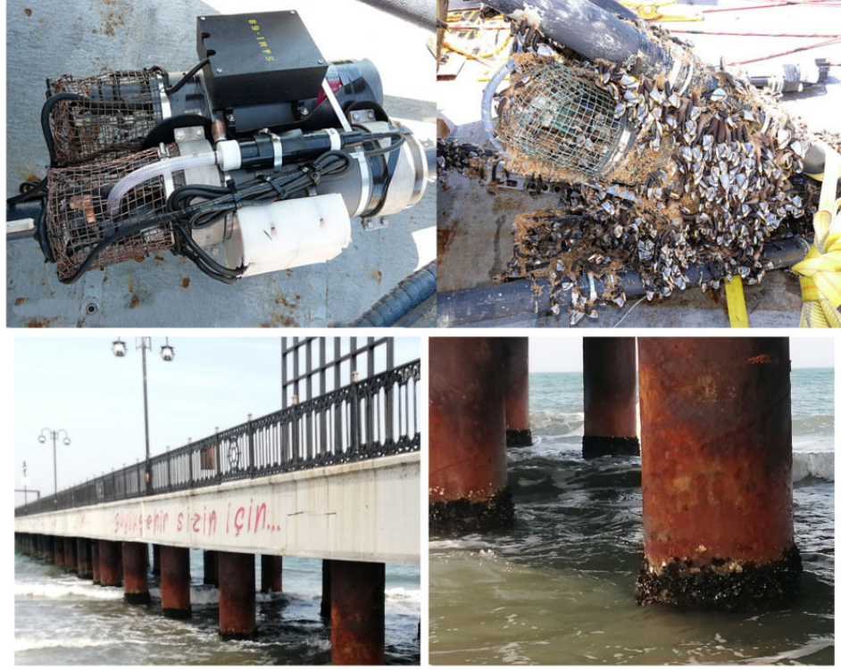
Şekil 2.4. Bazı yapılarda kekamoza oluşumu a. Su altı ekipmanlarında zamanla oluşan kekamoza (Schilling, 2015) b. İskele ayaklarında midye kaynaklı sert kekamoza oluşumu
