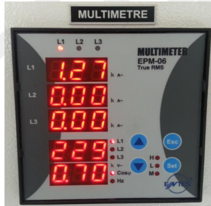
Şekil 20. Harcanan elektriği gösteren Entes EPM-06 marka multimetre.
