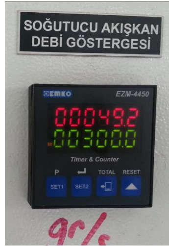
Şekil 19. Soğutucu Akışkan Debimetresi.
