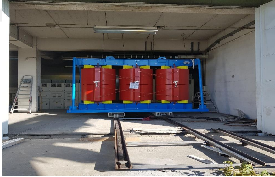
Şekil 2.12 : Metro İstanbul cer transformatörleri.
