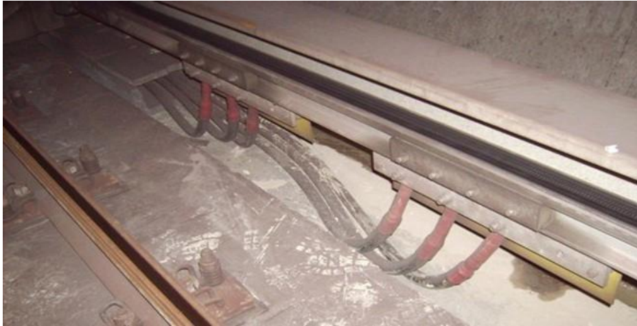
Şekil 2.24 : 3. Ray kablo bağlantıları.
