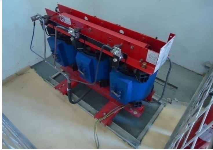
Şekil 2.13 : Metro İstanbul iç ihtiyaç transformatörleri.
