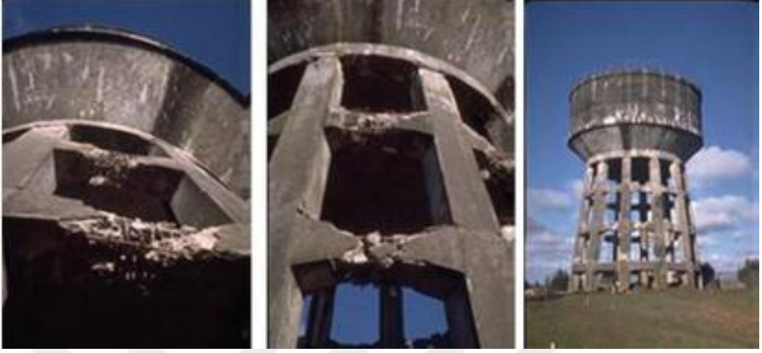
Şekil 2.4: Depremde 700 m 3 kapasiteli yükseltilmiş su deposu 1960 Şili
