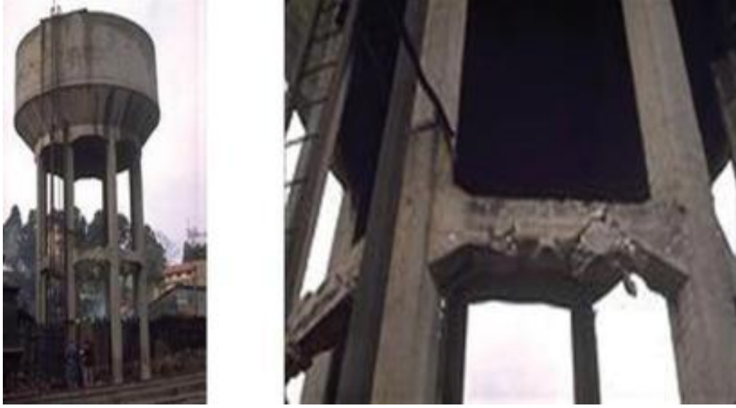
Şekil 2.2: 50 m 3 kapasiteli yükseltilmiş su deposu, Şili depremi [2].
