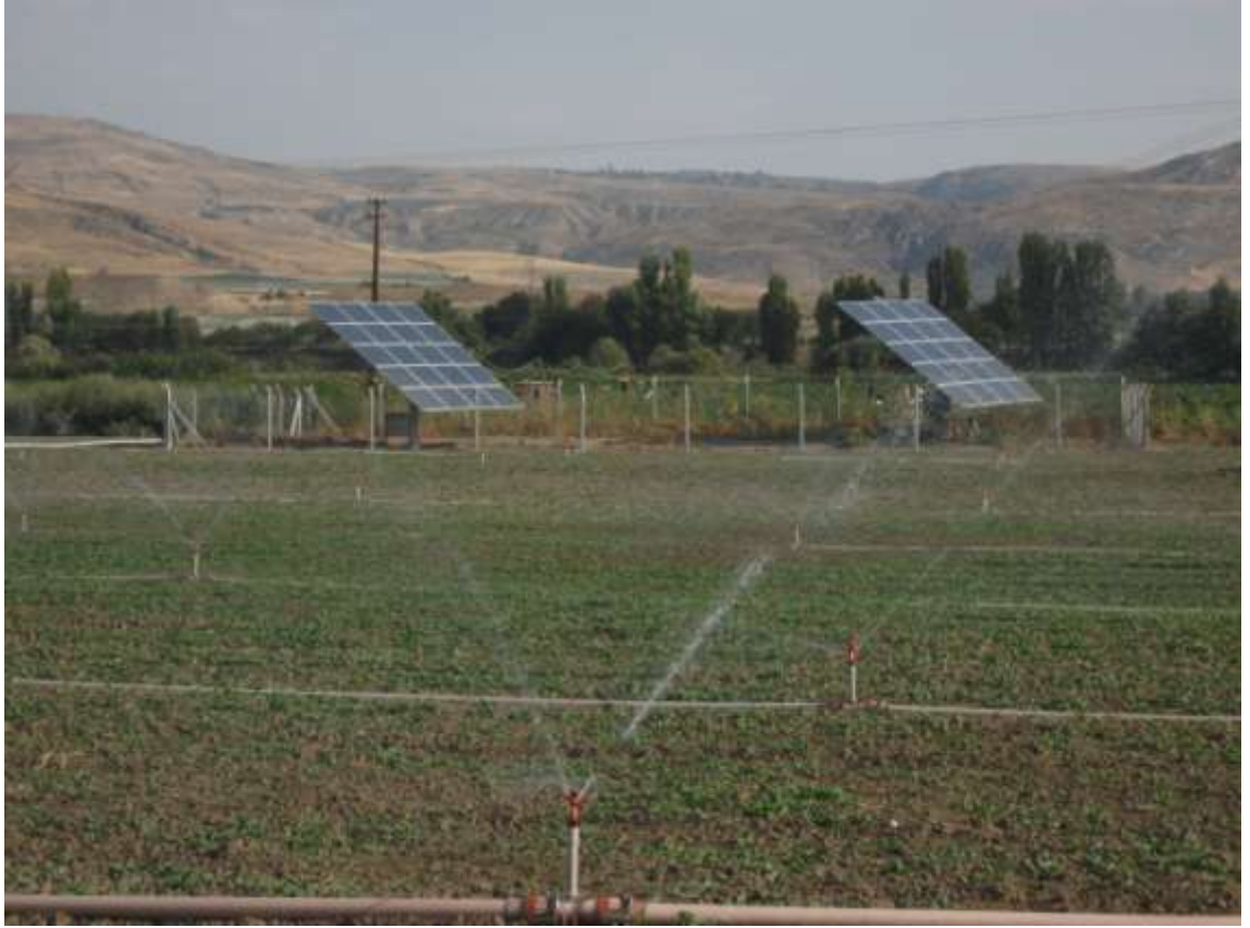
Şekil 6.1 Sulama amaçlı güneş takip sistemli güneş enerjisi ile elektrik üretimi tesisi (Beypazarı)
