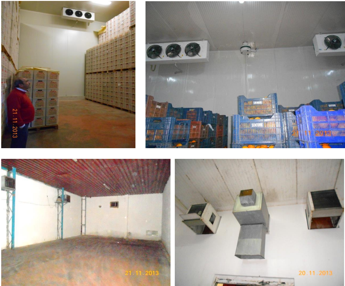
Şekil 4.11. 2013-2014 döneminde Hatay ilinde anket yapılan soğuk hava depolarında soğutma sistemlerinden görüntüleri
