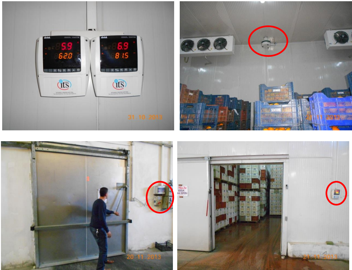
Şekil 4.13. 2013-2014 döneminde Hatay ilinde anket yapılan soğuk hava depolarında sıcaklık-nem kontrolü ve nemlendirme ünitesi
