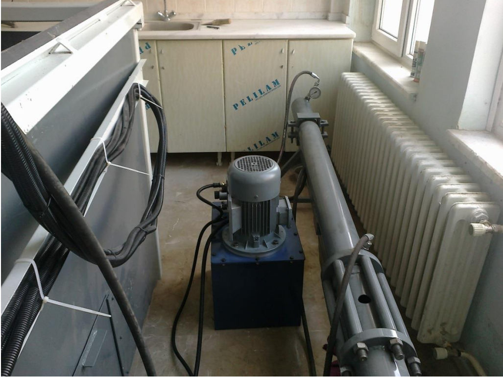
Şekil 3.2. Pompa ve kompresör
