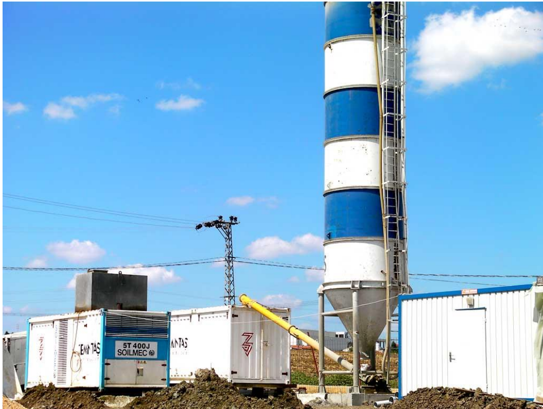
Şekil 2.26. Çimento silosu (zemintaş)
