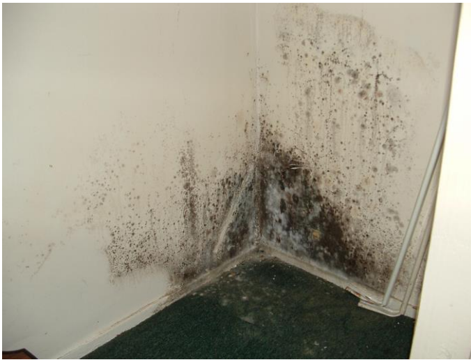
Şekil 22: Nemden dolayı oluşan küf
