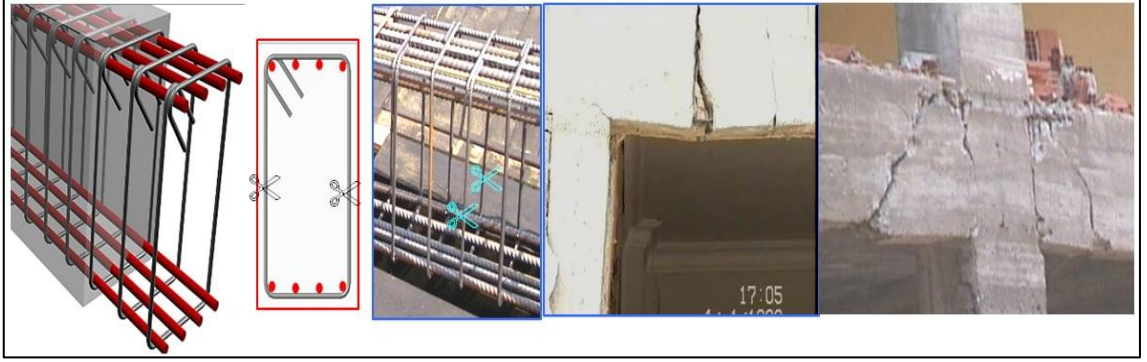
Şekil 4.12. Etriye sıklaştırması yapılmamış kirişlerdeki hasarlar
