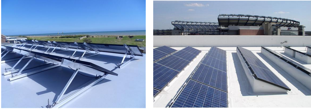
Şekil 3.30 : Düz çatıda fotovoltaik panel uygulaması [61].
