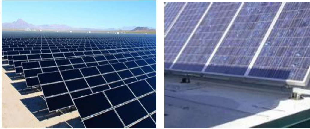
Şekil 3.26 : Panellerin birbirini gölgelemesi [16].
