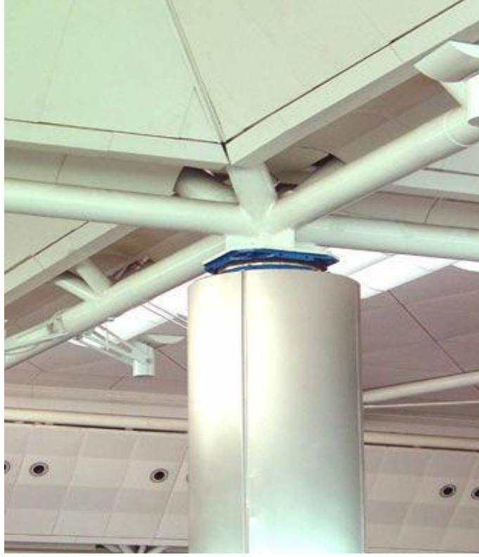
Şekil 2.1. Atatürk Havaalanı dış hatlar binasında kurulu olan izolatör
