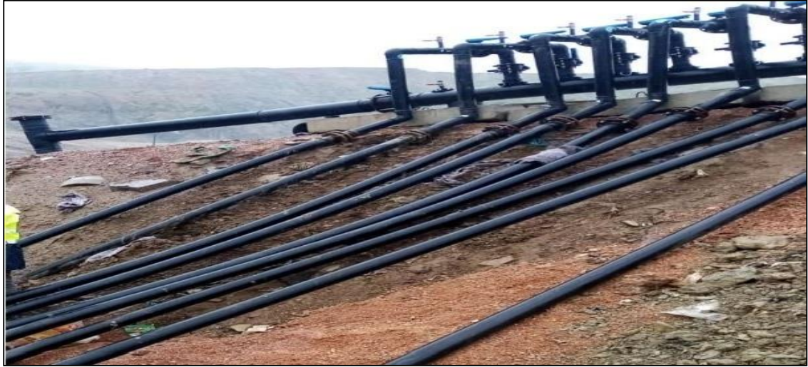
Görsel 2.2: Gaz Toplama İstasyonu ve Bu Yapıya Bağlı Emiş Hatları
