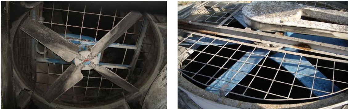
Şekil 6.12. Uygulama öncesi ve sonrası soğutma kulesi fan kanatları görünümleri (Encon Group, 2019)
