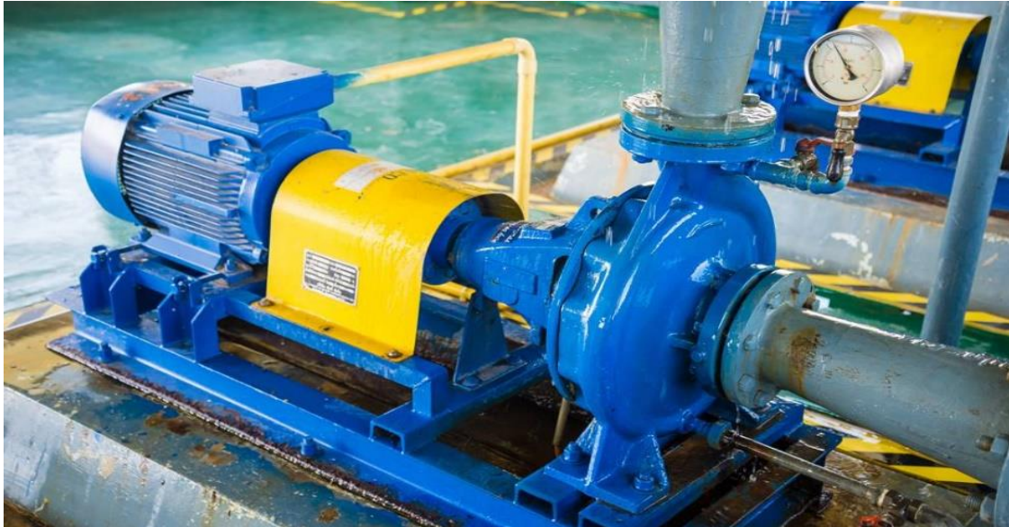
Şekil 4.10. Pompa, bağlantı elemanı ve elektrik motoru görünümü (URL-9)
