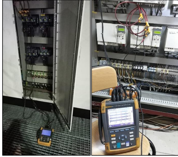
Şekil 5.5. Soğutma kulesi pompalarında enerji analizörü ile aktif güç ölçümleri
