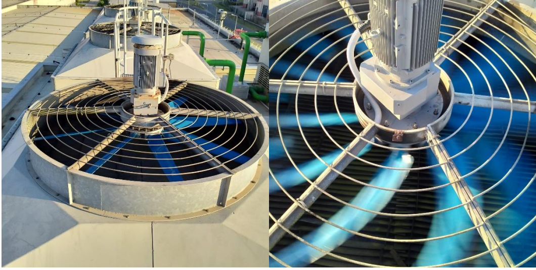
Şekil 3.11. Soğutma kulesi aksiyel fan görünümleri
