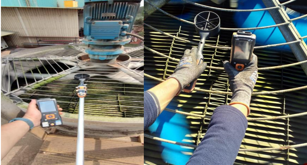
Şekil 5.3. Soğutma kulelerinde havanın çizgisel hız ölçümü
