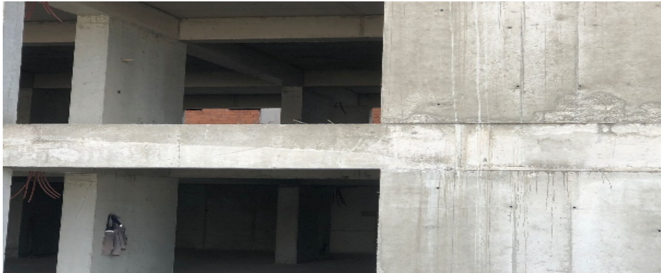
Resim 1.1 Betonarme Kirişlerde İmalat Sırasında Oluşan Soğuk Derz.
