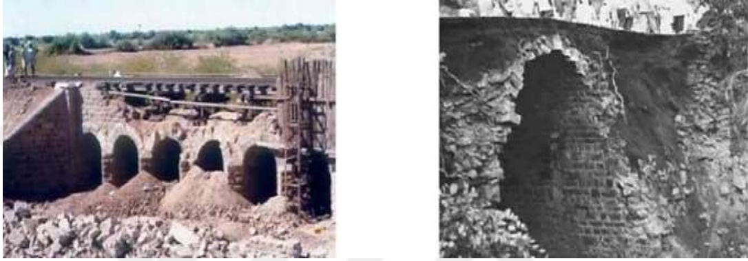
Şekil 3.15. Hindistan Bhurj ve Koyna depreminde hasar gören köprüler (Yanık vd. 2017)
