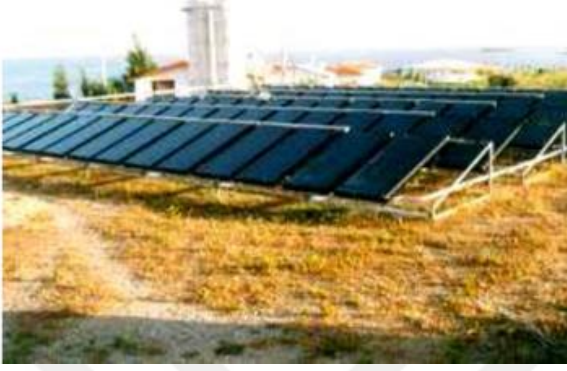
Şekil 2.4. Düzlemsel güneş kolektörleri
