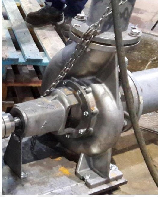
Şekil 5.8. Pompa sistemi görüntüsü.
