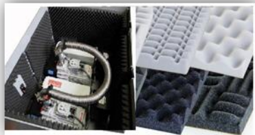
Jeneratör odalarında bulunan süngerler
