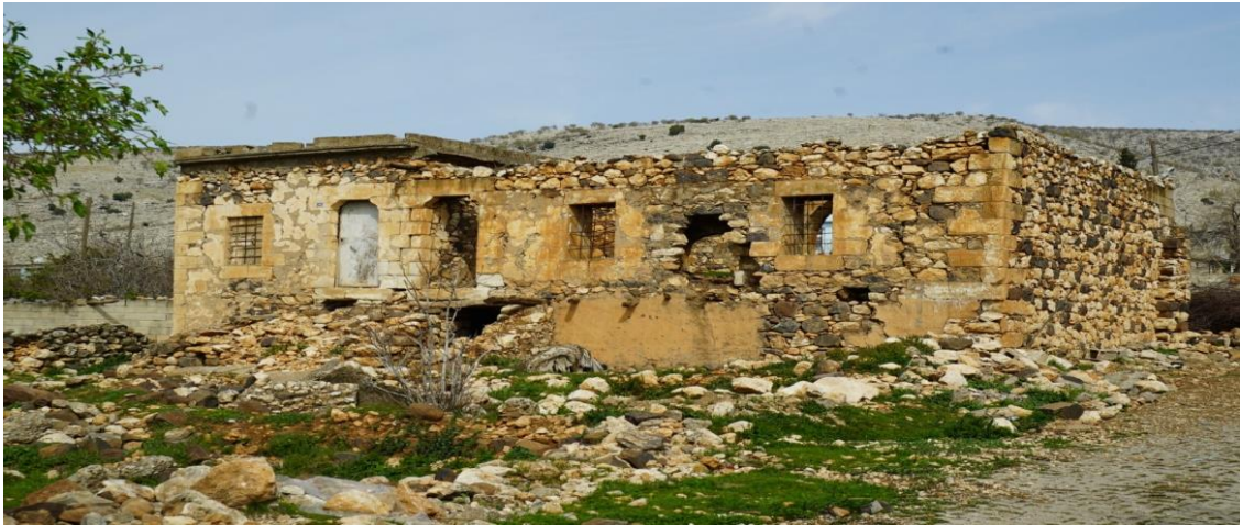
Fotoğraf 2.4. Birçoğu Yıkılmış veya Yıkılma Tehlikesi Yaşayan Eski Tip Meskenler.
