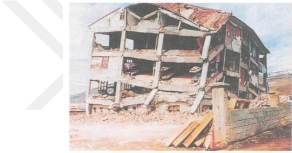
Şekil 2.4. Erzincan 1992 depremine ait bir görsel , (Fotoğraf: Fahrettin Şener) Kolon ve kiriş bağlantıları zayıf binadaki hasar (Atabey,2000)
