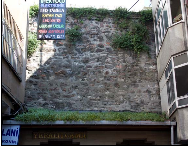
Şekil 3.49 : Kemankeş Caddesi'nde 94 ada 9 parselde bulunan eski Galata Mahzeni olan Yeraltı Camii kuzeybatı duvarı (Okur, E., 2011)
