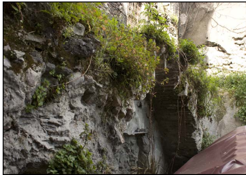
Şekil 3.31 : Arap Camii Mahallesi Fermeneciler Caddesi 1122 adada 7 ve 8 parsellerde bulunan kemerli sur duvarlarının güney cephesi (Okur, E., 2011)
