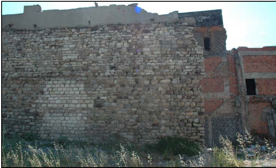
Şekil 3.20 : Tersane Caddesi üzerinde 1488 ada 25, 67, 66, 56, 100 parsellerde yer alan duvar üzerinde kapatılan Cevahir Çıkma Geçidi (Bimtaş, 2009)
