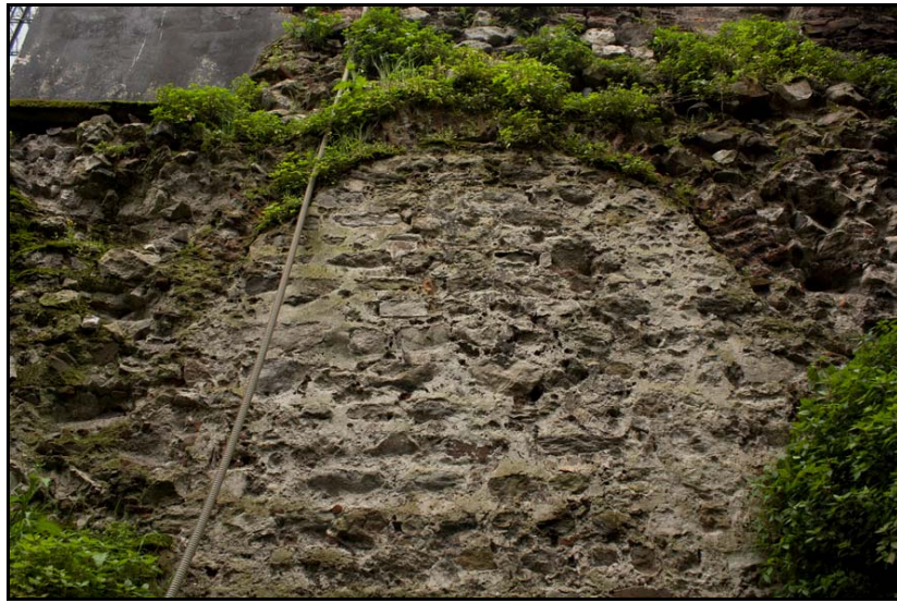
Şekil 3.30 : Arap Camii Mahallesi Fermeneciler Caddesi 1122 adada 7 ve 8 parsellerde bulunan sur duvarlarının kuzey cephesinde kapatılan kemer boşluğu (Okur, E., 2011)
