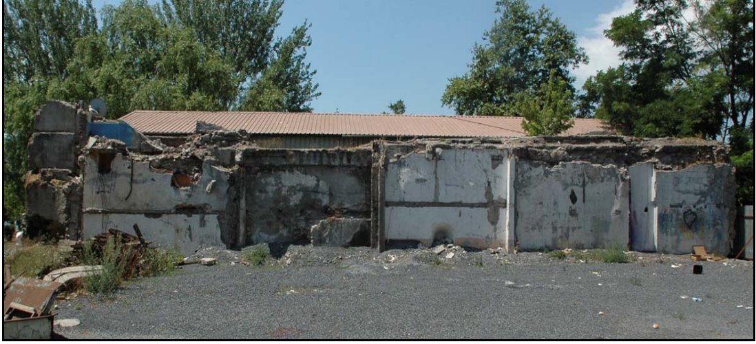
Şekil 3.23 : Tersane Caddesi üzerinde 1488 ada 86, 83, 102, 17, 18, 19, 20, 21, 22 parsellerin yıkılması ile çıkan duvarın kuzey cephesi (Bimtaş, 2009)
