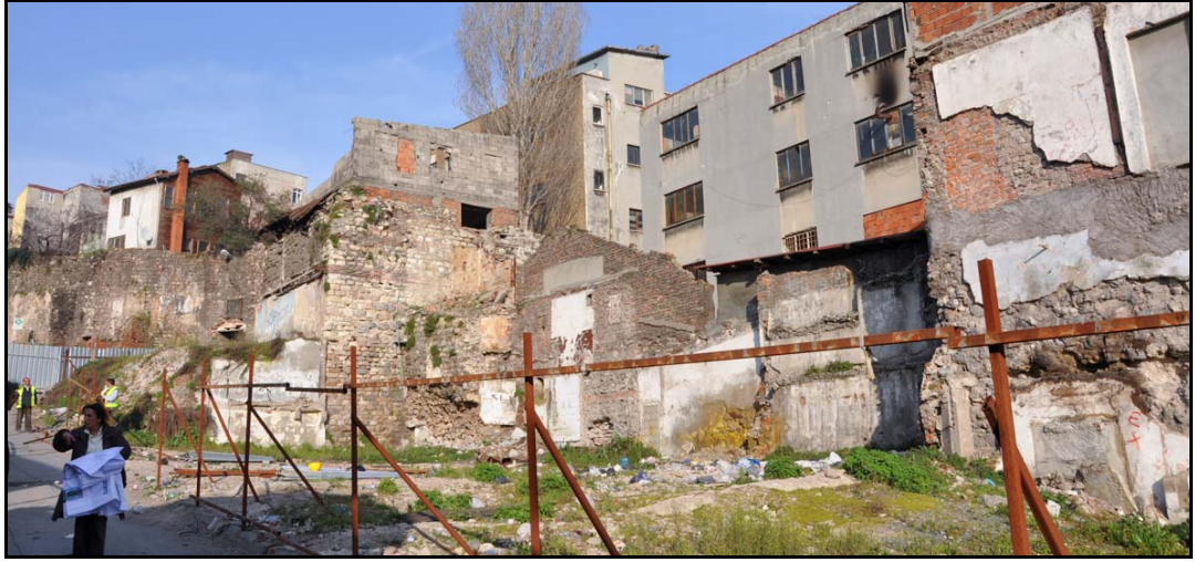
Şekil 3.15 : Yolcuzaade Sokak 253 adada yer sur duvarı (İstanbul II Numaralı Kültür ve Tabiat Varlıklarını Koruma Kurulu, 2009)
