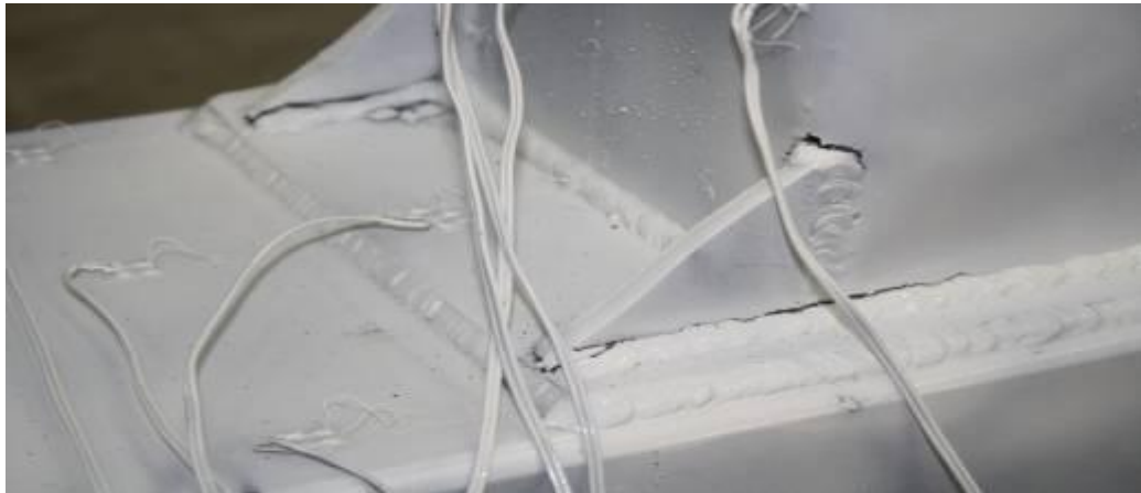
b) Yatay yükleme sonrası berkitme elemanlarındaki kaynak yırtılması
