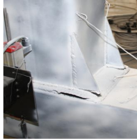
d) Kaynak yırtılması
