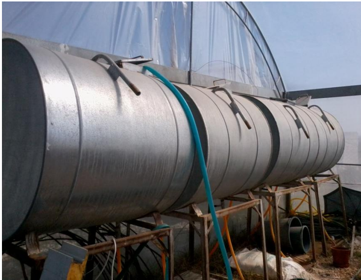
Şekil 3.3. Sulamada kullanılan su tanklarının görünümü
