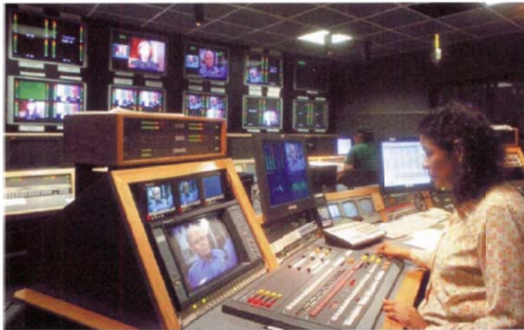
Resim 2.5. Master kontrol odası [9]
