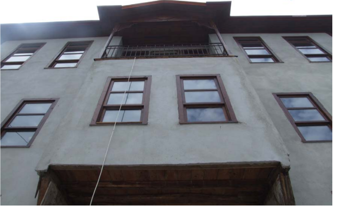
Foto 6.5. Dođu Cepheden Giriř Üzerindeki ıkma ve Balkon (Katalog 1)
