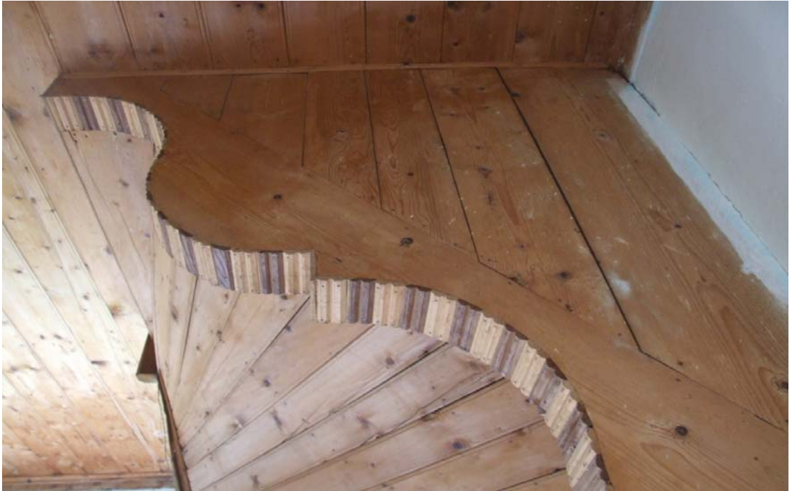
Foto 6.14. Merdiven Altındaki Ahşap Konsol (Katalog 1)
