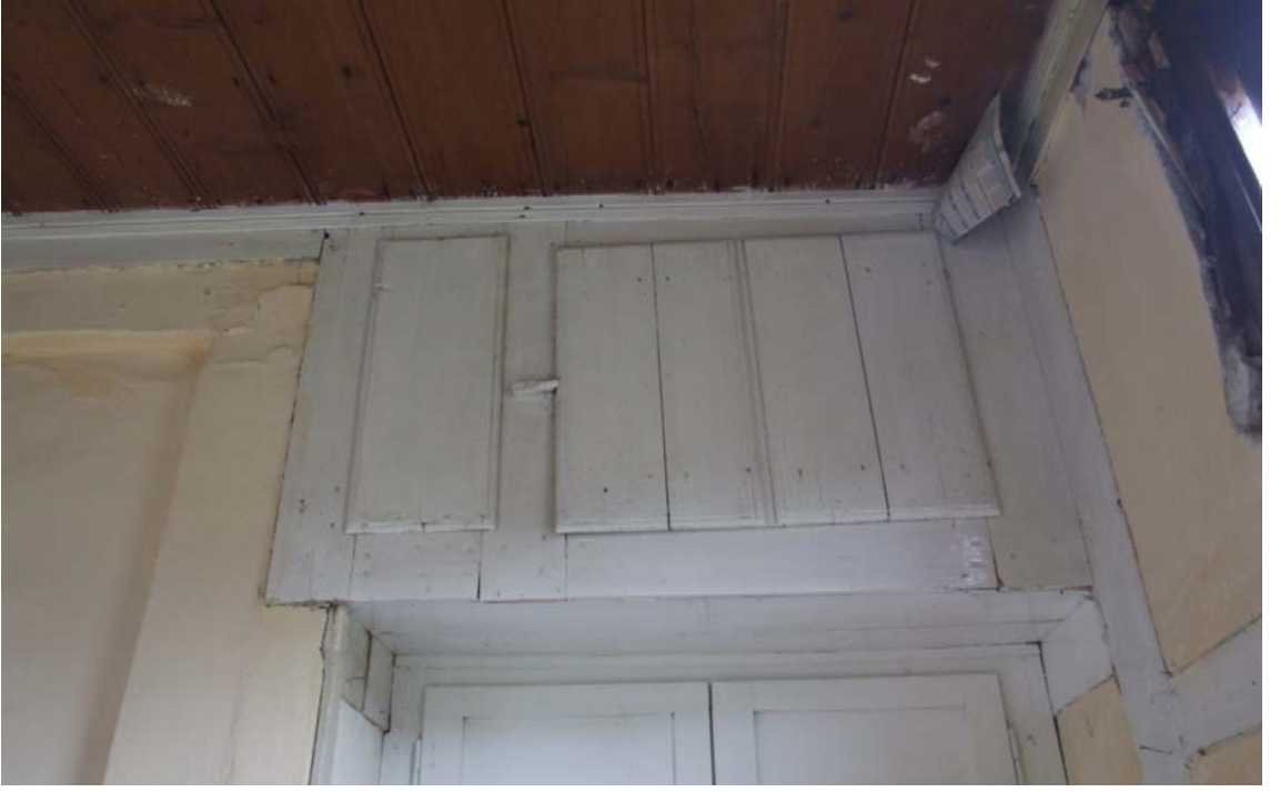
Foto 6.11. Mutfak Dolapları (Katalog 1)
