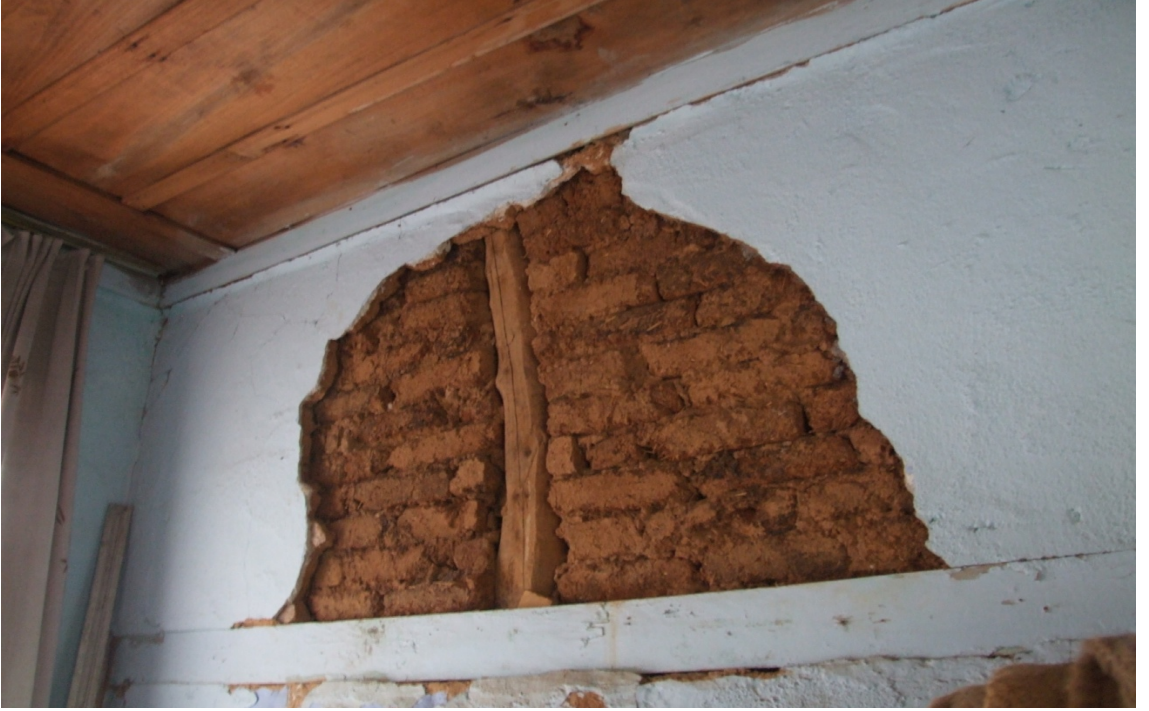
Foto 6.105. Sıvası Dökülmüş Duvardan Görünüş (Katalog 7)
