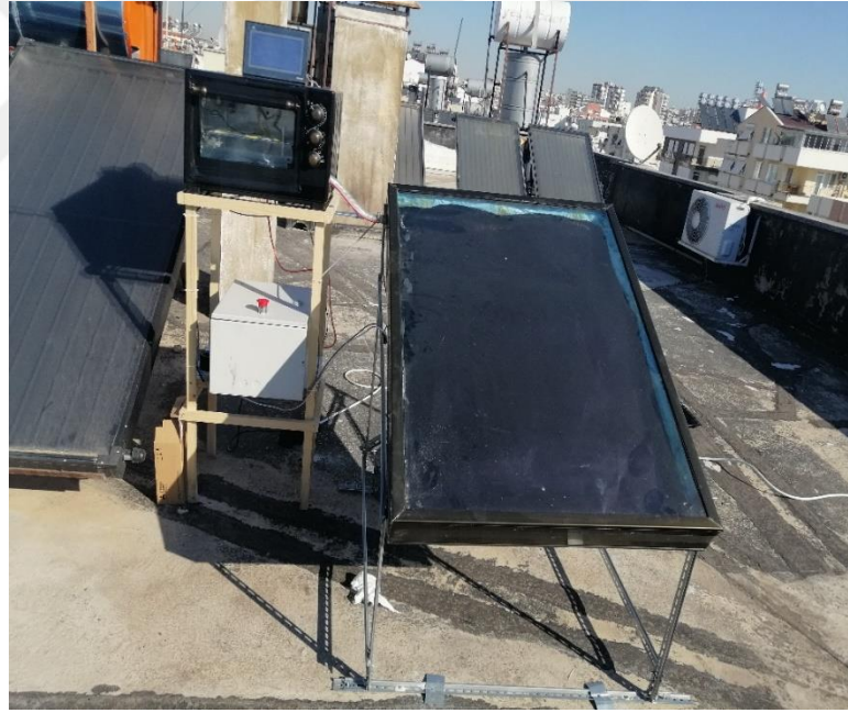
Şekil C.10. Tasarımı yapılan yenilenebilir enerji kaynaklı gıda kurutucusu çatıdaki kurulumu
