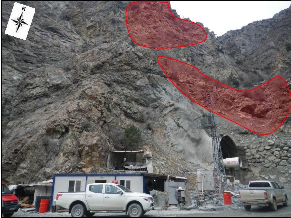
Şekil 2.1. Yusufeli ilçesinde yamaç üzerinde ve askıda kaldığı tespit edilen serbest kaya blokları (X: 465 311, Y: 4 520 183 (TM42-ITRF96)).
