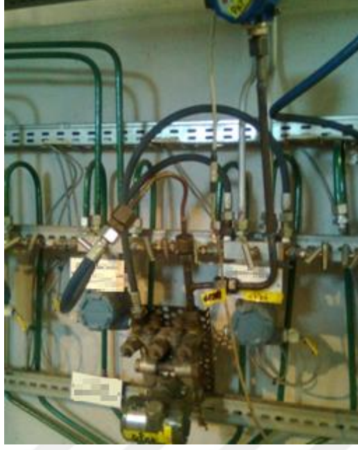
Şekil 3.8 Fark-basınç transmitterlerinin bağlantısı
