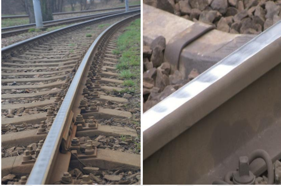
Şekil 4.2: Deforme Olan Ray Yüzeyi
