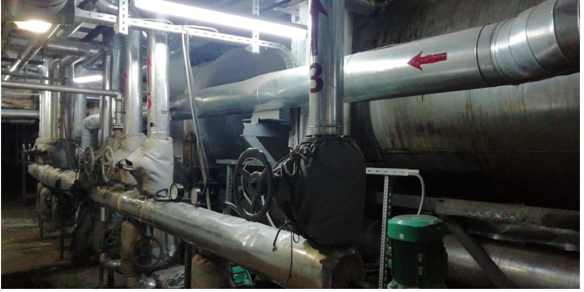
Şekil 2.7 Kazana Giden Besi Hattı Ve Besi Pompaları (İbiş,2021)
