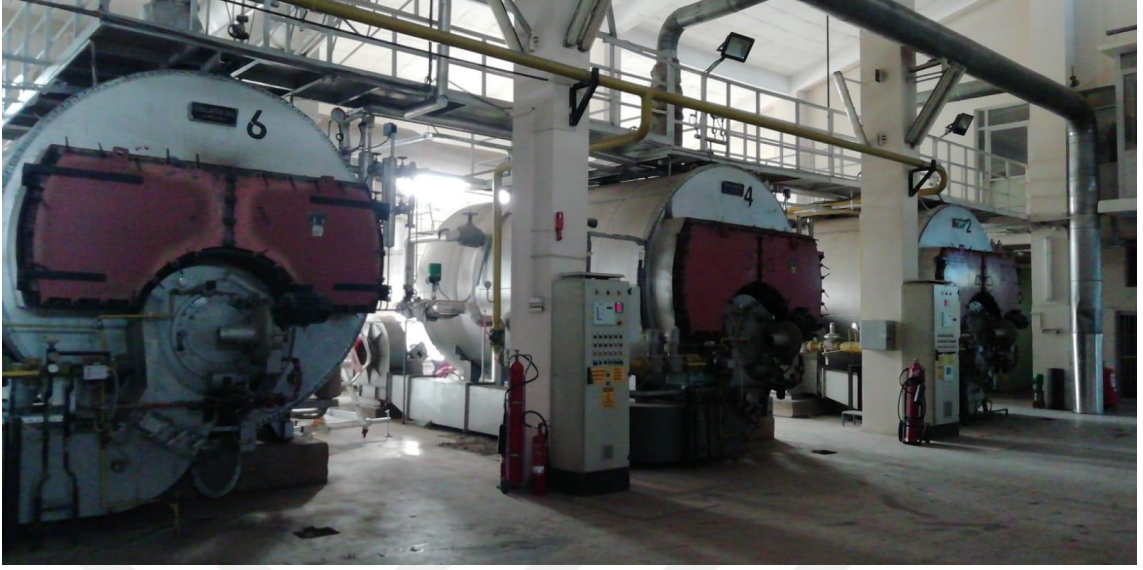
Şekil 2.3 2-4-6 Nolu Kazanların Genel Görünüşü (İbiş,2021)
