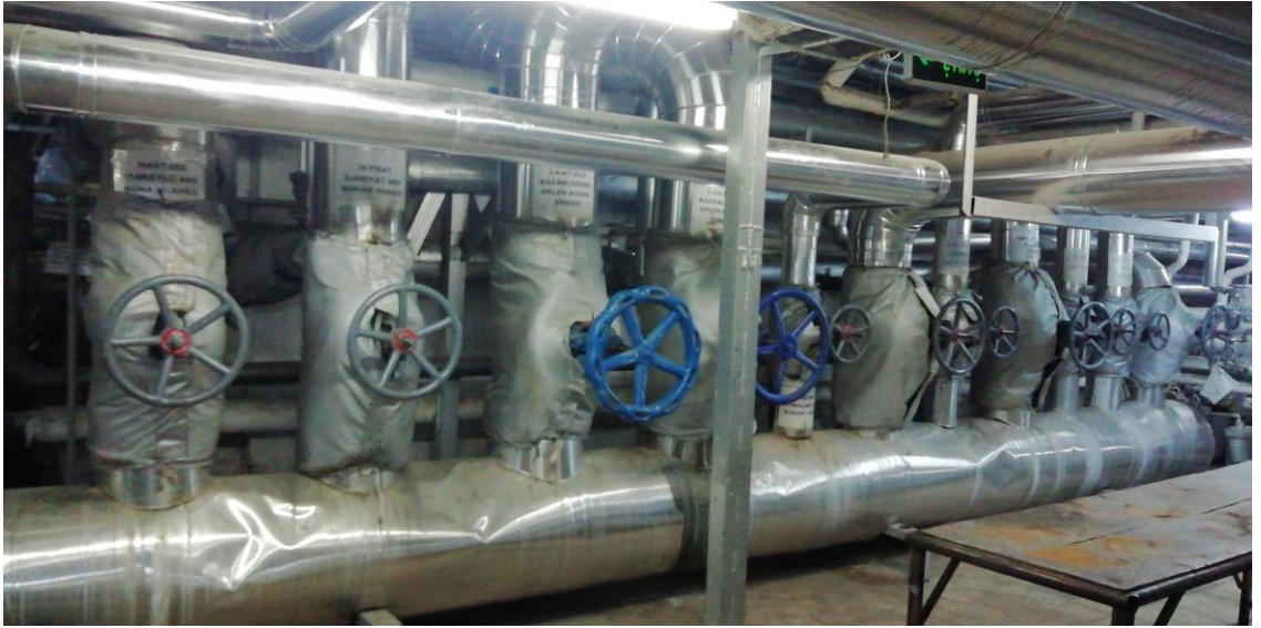
Şekil 2.8 Buhar Dağıtım Kollektörleri (İbiş,2021)
