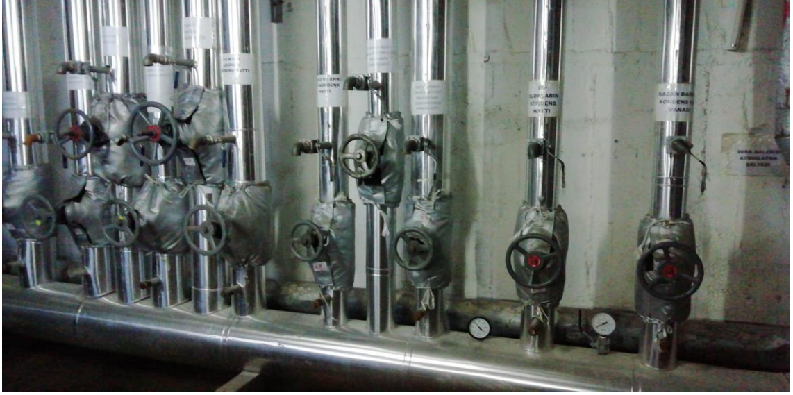
Şekil 2.10 Eşanjörlerden Dönen Kondens Hattı (İbiş,2021)
