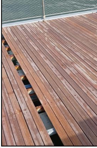
Şekil 4.116 Donanmacı Mahallesi: Yer Döşemesi Kalkmış/Sökülmüş İskele Zemini
