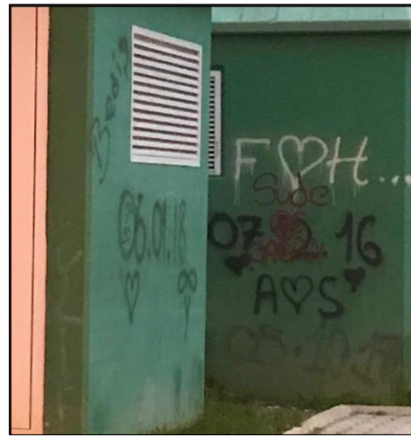
Şekil 4.71 Bostanlı Mahallesi: Şehit Jandarma Er İlhami Yılmaz Parkı- Trafo Binası ve Grafiti
