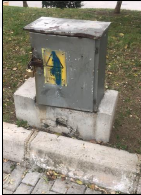
Şekil 4.169 Cumhuriyet Mahallesi: Sevgi Parkı-Elektrik Panosu
