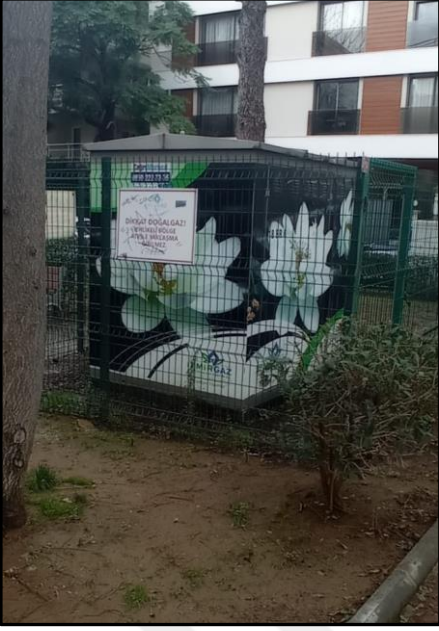
Şekil 4.130 Donanmacı Mahallesi: Zafer Alataş Parkı- Doğal Gaz Kutusu
