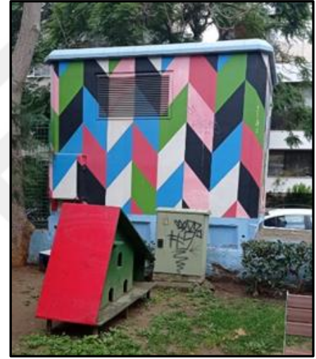
Şekil 4.129 Donanmacı Mahallesi: Zafer Alataş Parkı- Kedi Yuvası ve Trafo
