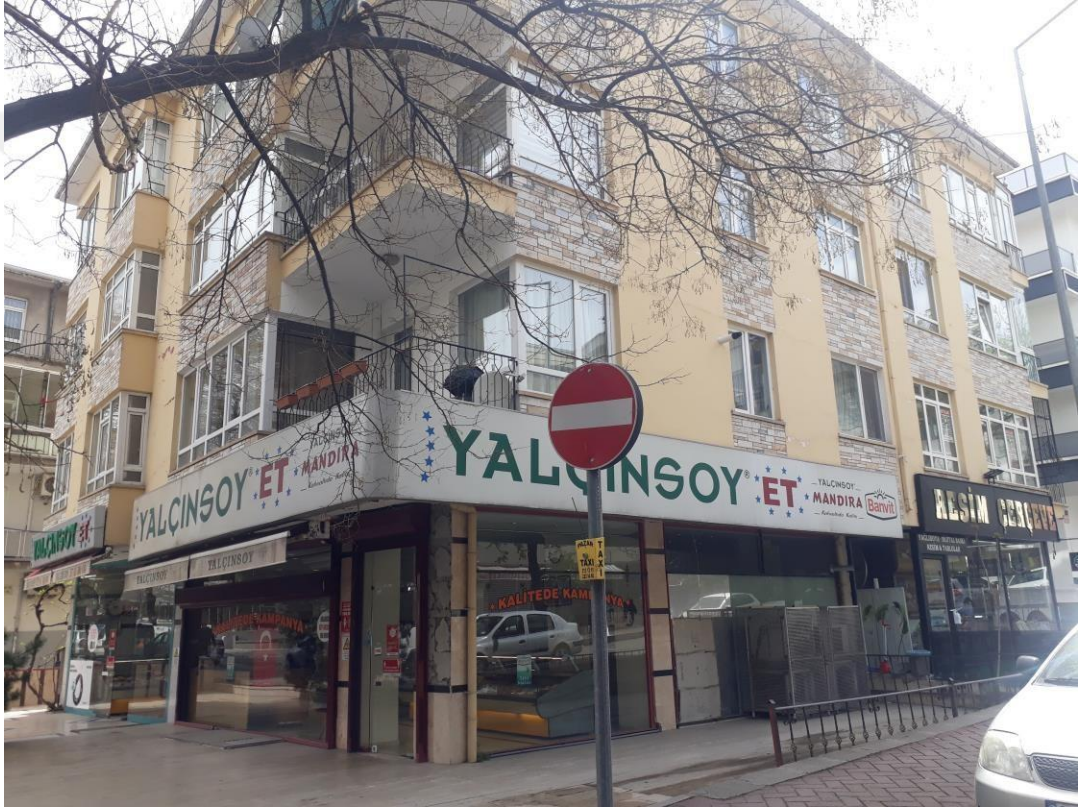
Şekil 2.3. Betonarme binalarda yumuşak kat örneği
