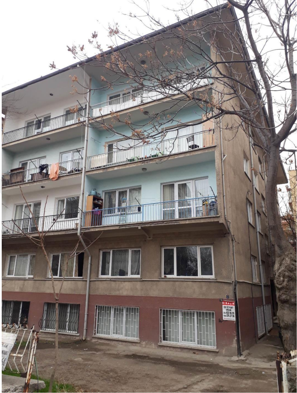
Şekil 2.11. Görünen yapı kalitesinin kötü olduğu betonarme bina örneği
