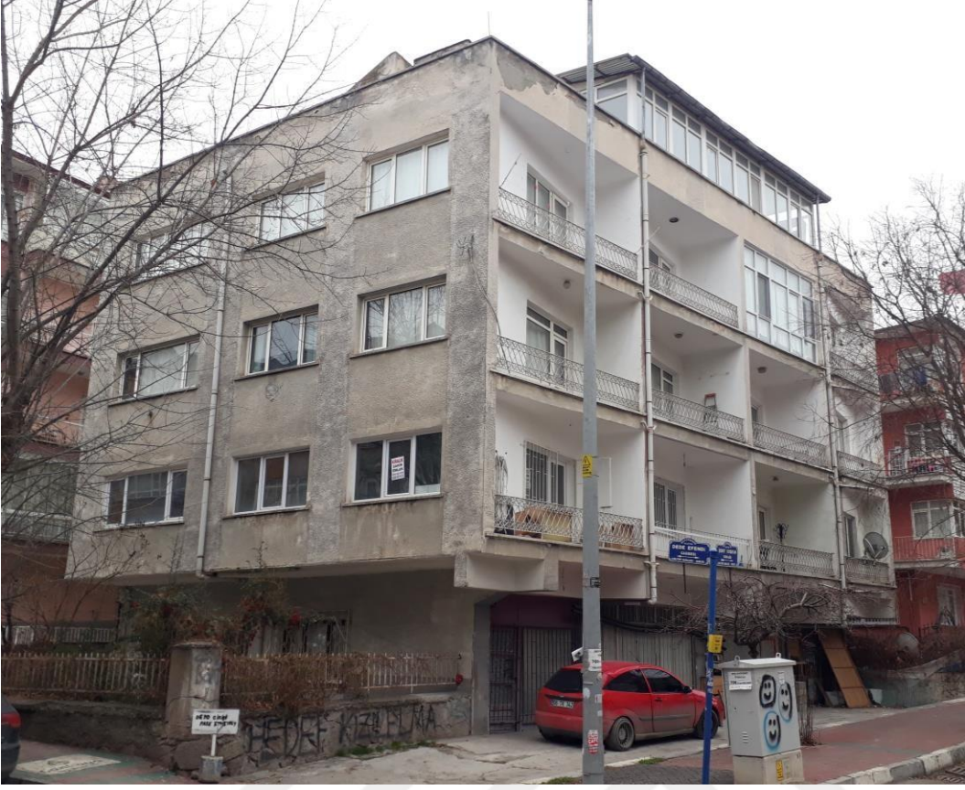
Şekil 2.12. Görünen yapı kalitesinin kötü olduğu betonarme bina örneği
