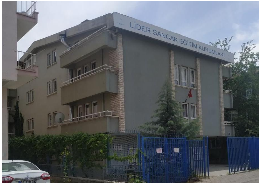
Şekil 2.6. Betonarme binalarda ağır çıkma örneği
