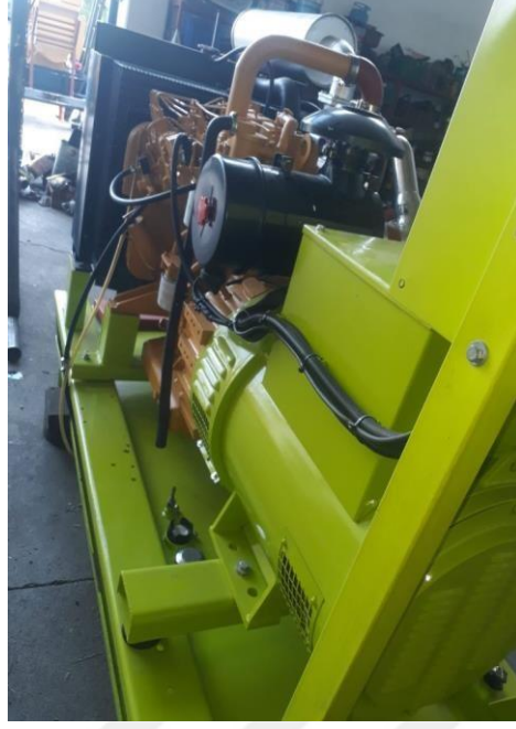
Şekil 5.1. Elektrikli Dizel Jeneratör
