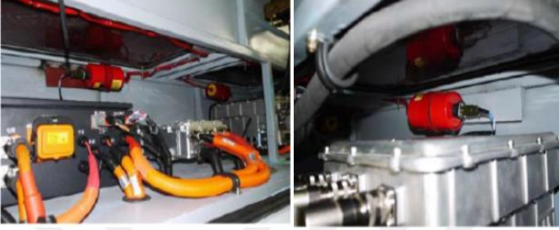
Şekil 5.2. Elektrikli araç üzerinde kurulu durumdaki yoğunlaştırılmış aerosol yangın söndürücüler
